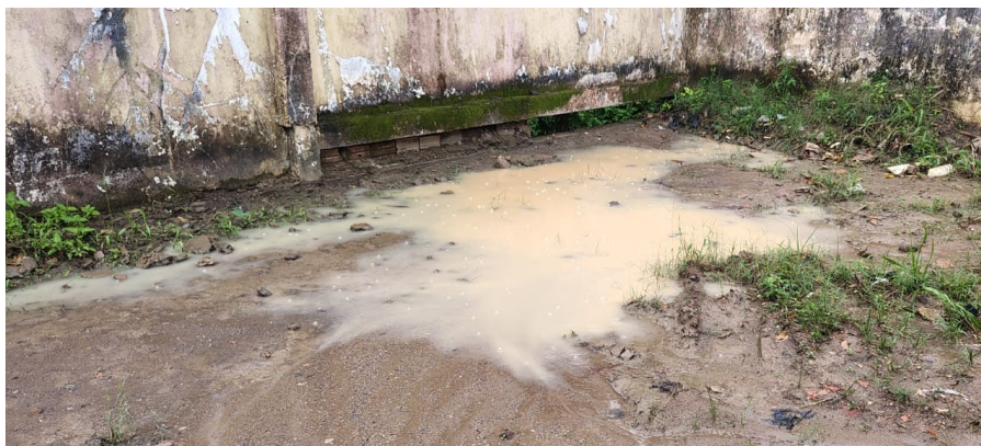
Figura 3: Drenagem. Fonte: COSAMA, 2025.
