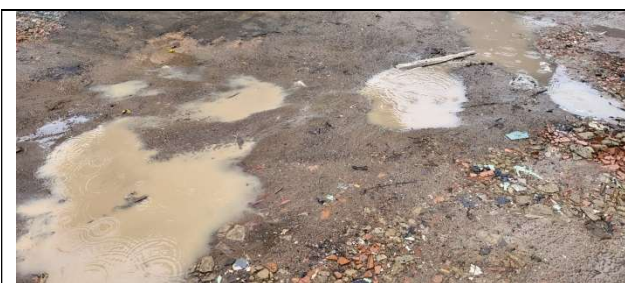
Figura 6: Pavimento acúmulo de água da chuva. Fonte: COSAMA, 2025
