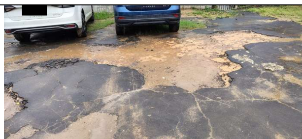
Figura 7: Pavimento, composta por uma combinação de asfalto desgastado e áreas expostas de terra. Fonte: COSAMA, 2025
