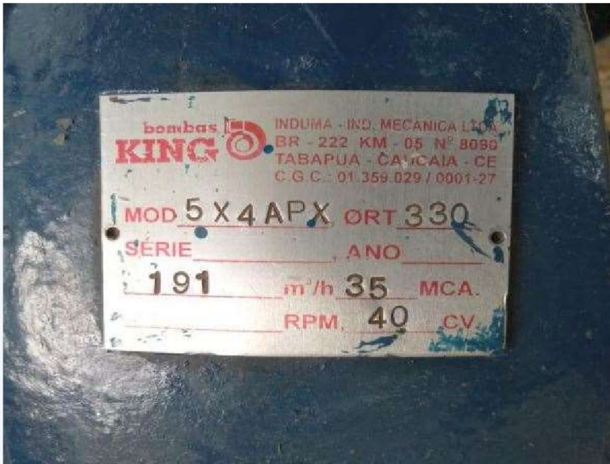
PLAQUETA DE IDENTIFICAÇÃO DA BOMBA
