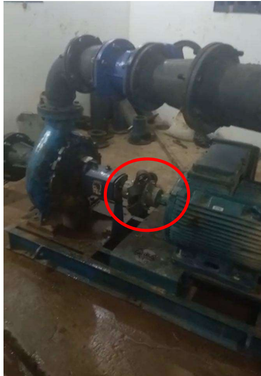
Fotografia 01: Vista parcial do conjunto motobomba de 75cv da captação superficial na agencia de São Paulo de Olivença. Ênfase no complemento elástico.
