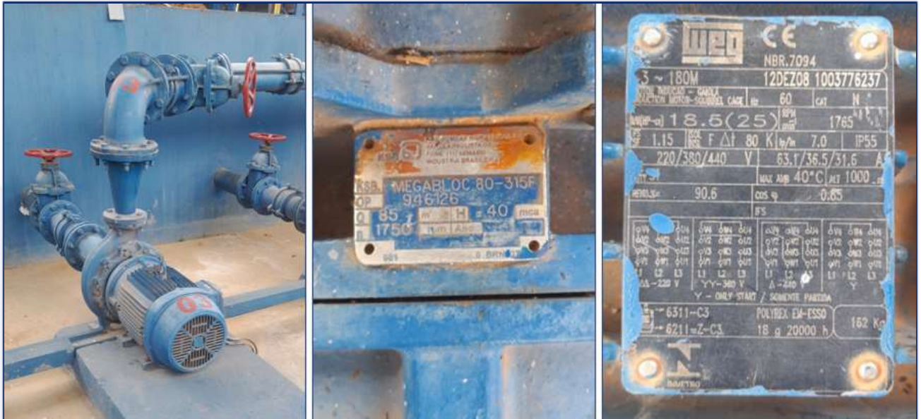
Figura 3 - Elevatória de Água Tratada 03 (conjunto 03)
