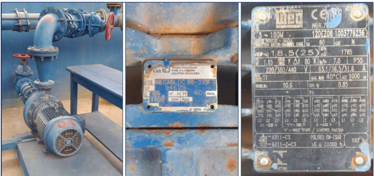
Figura 4 - Elevatória de Água Tratada 04 (conjunto 04)
