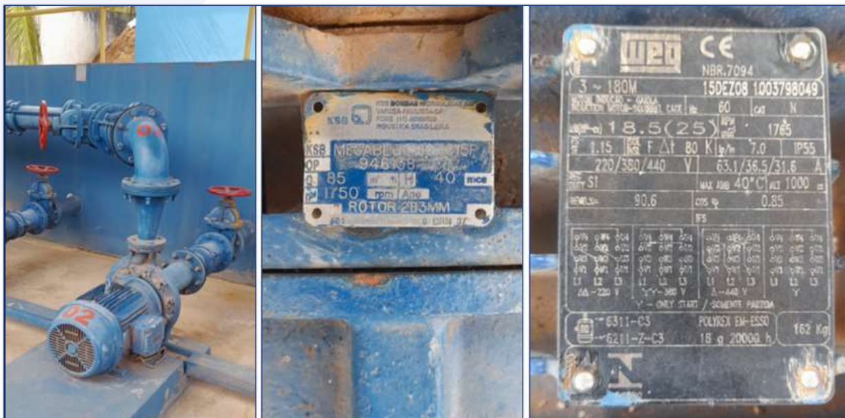
Figura 2 - Elevatória de Água Tratada 02 (conjunto 02)
