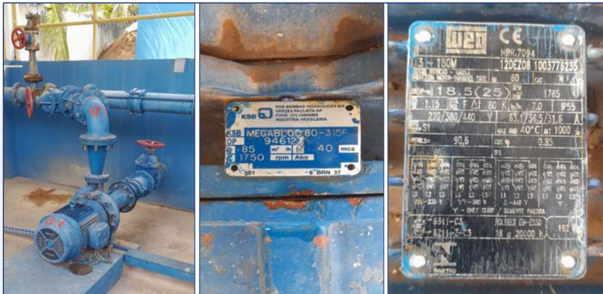
Figura 1 - Elevatória de Água Tratada 01 (conjunto 01)
